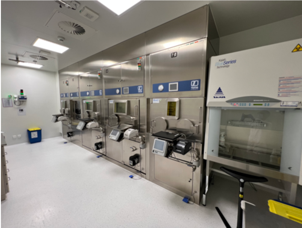
Abb. 18 Hinter den Chromstahlüren dieser strahlungsabgeschirmten Reinraumzellen stehen die Synthese- und Abfüllautomaten der Radiopharmazie.
