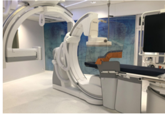
Abb. 15 Strahlenschutzmassnahmen für das medizinische Personal, hier umgesetzt an einer biplanaren Durchleuchtungsanlage mit deckenmontierter Bleiglasscheibe und Untertischschutz
