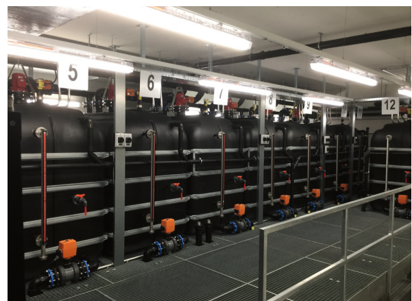
Beispiel einer Abwasserkontrollanlage. Foto: P. Koch
