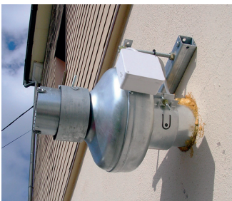
Ein aussen liegender Ventilator erzeugt einen leichten Unterdruck unter der Bodenplatte.
