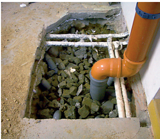
Punktueller Absaugung (Radonbrunnen) – Auslass eines Schachtes.
