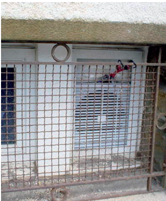
Mit einem kleinen Ventilator wird im Kellergeschoss oder Kriechkeller ein Unterdruck gegenüber dem Wohnbereich erzeugt.
